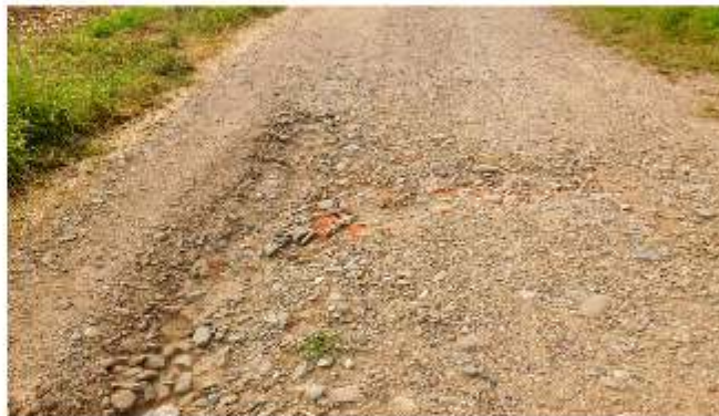
Obr. 5: Zprava ze svahu stéká rovnou na cestu proud vody, který dříve končil v asi 3m širokém remízku s několika ovocnými stromy a křovinami, s hubkou rýhou na zachycení vody. Prominentní chataři remízek na cizím pozemku vykáceli a rýhu zasypali stavebním odpadem. Prý se tam lépe otáčí autem...
